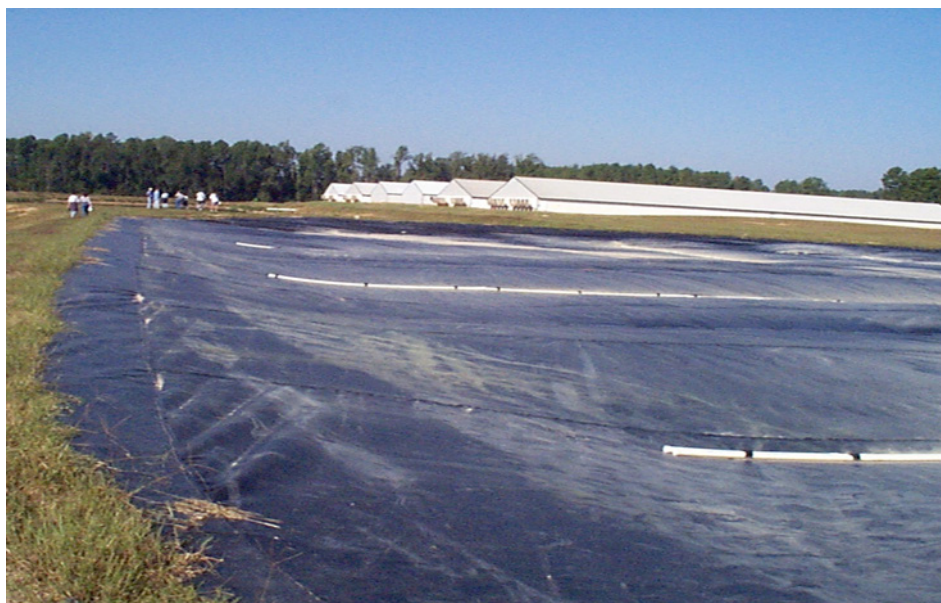
FOTO 6: DIGESTOR TIPO “LAGUNA CERRADA”
